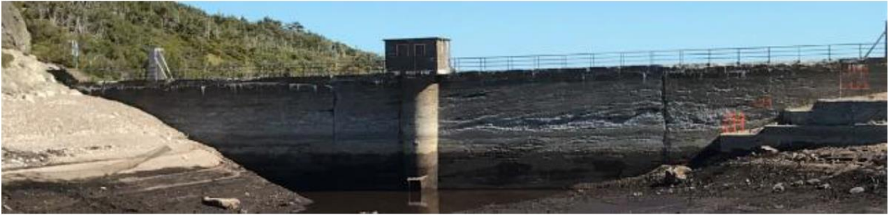
Figure 1: Vue d'ensemble du parement amont du barrage (Source : Reconstruction du barrage de la Vigie – Phase 1 – Rapport de diagnostic. ARTELIA, 2021)
