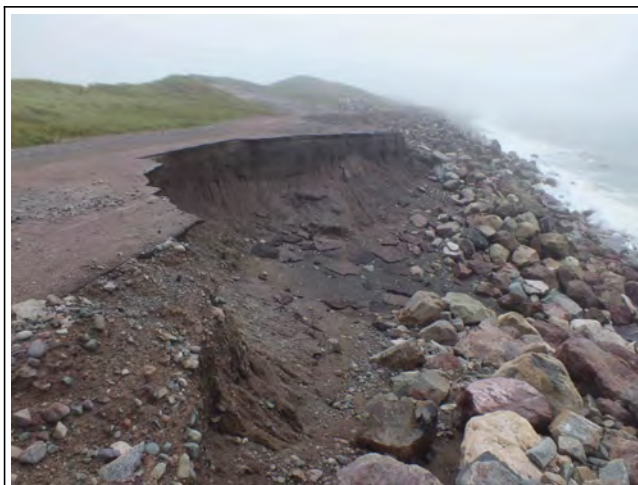
Effondrement stable sur la digue
