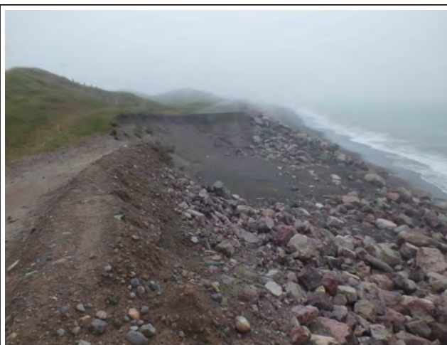
Effondrement stable en aval
