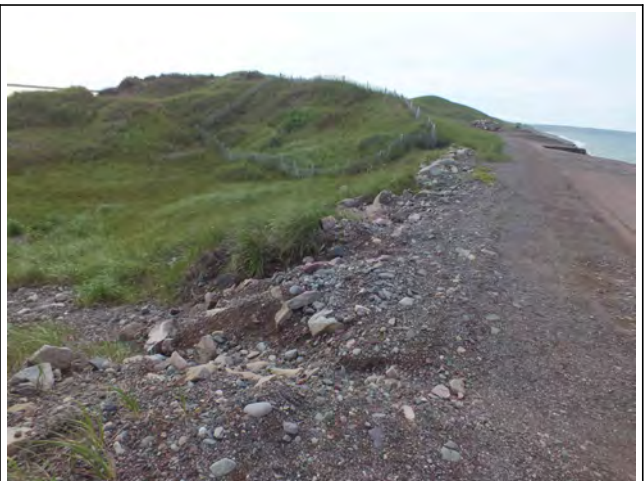
Légère évolution des ravinelements Est sur la digue
