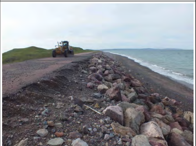
Affaissement aval vers PK17
