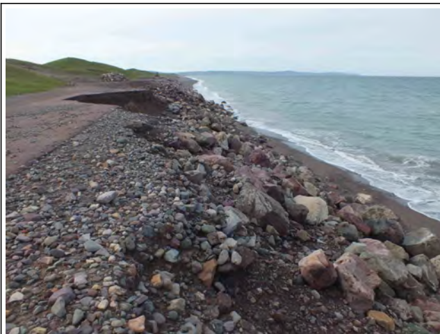
Effondrement stable sur la digue
